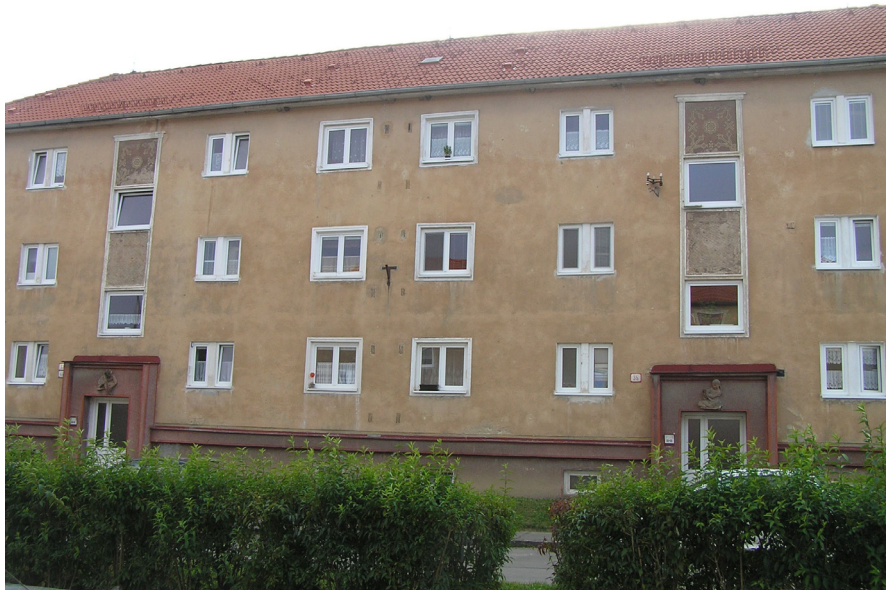
Objekt v havarijnom stave, vypadnuté sgraffito. Foto: M. Vanková.
