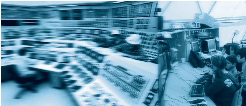
Sala de control de la Central Nuclear de Trojan (EE.UU.) | lab temporal Geografías Emergentes (Valdecaballeros, 2007) Trojan Nuclear Energy Plant control room (USA) | Emergent Geographies temporary lab (Valdecaballeros, 2007)
